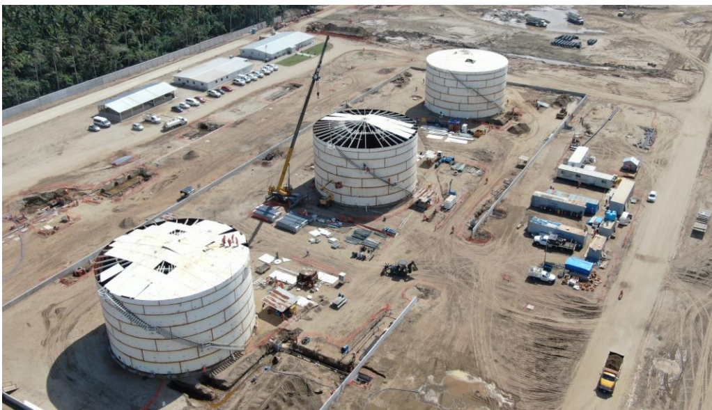
Figura 1. Tanques de almacenamiento de combustibles.
