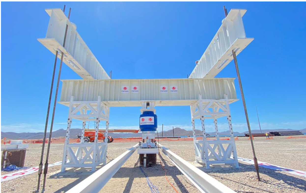
Vista general de una prueba de carga estática a compresión sobre una CMC
