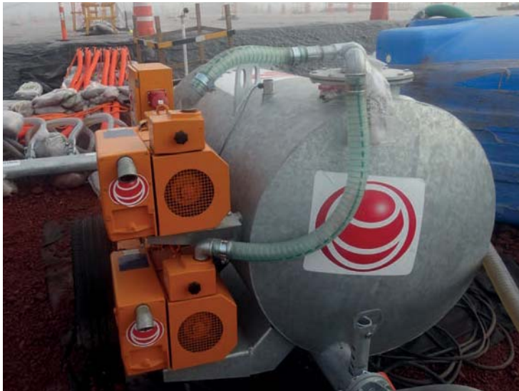
Figura 6. Vista de la estación de bombeo de vacío.
